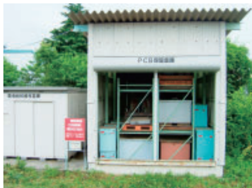
PCB保管倉庫
