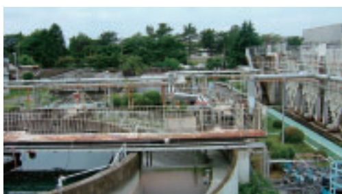
排水処理施設
