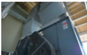
塗装工場の集塵設備
