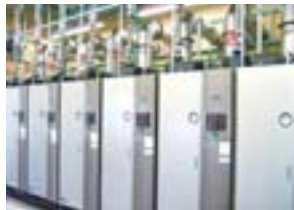
小型貫流ボイラー(鴻巣工場)
