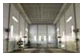
最新の塗装工場は、作業時の排気に配慮した設備になっています
