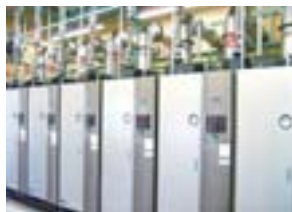
小型貫流ボイラー(鴻巣工場)
